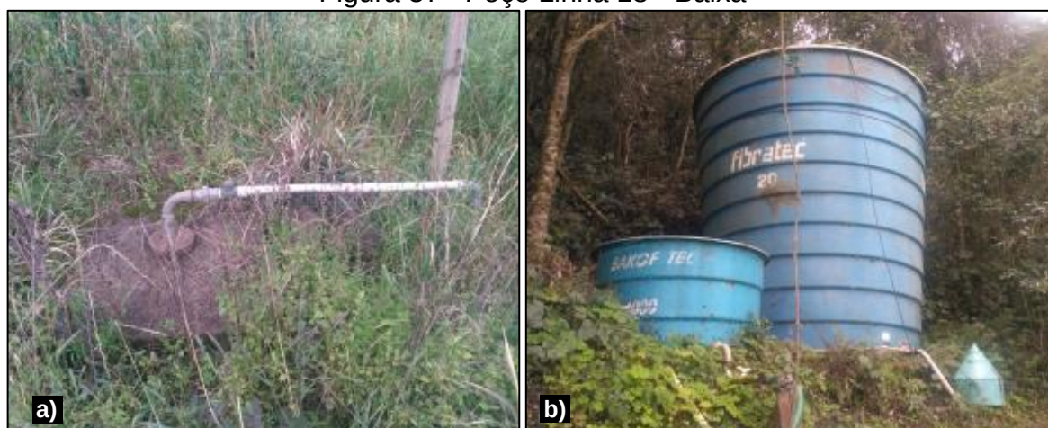
a) Poço de captação; b) Tratamento; c) Reservatório. Fonte: Vila Maria (2020).
