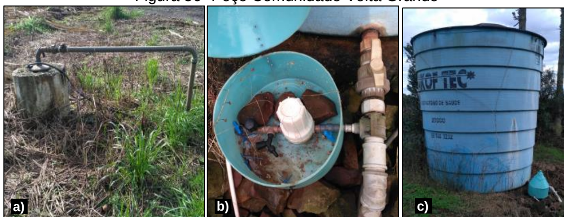
a) Poço de captação; b) Tratamento; c) Reservatório. Fonte: Vila Maria (2020).
